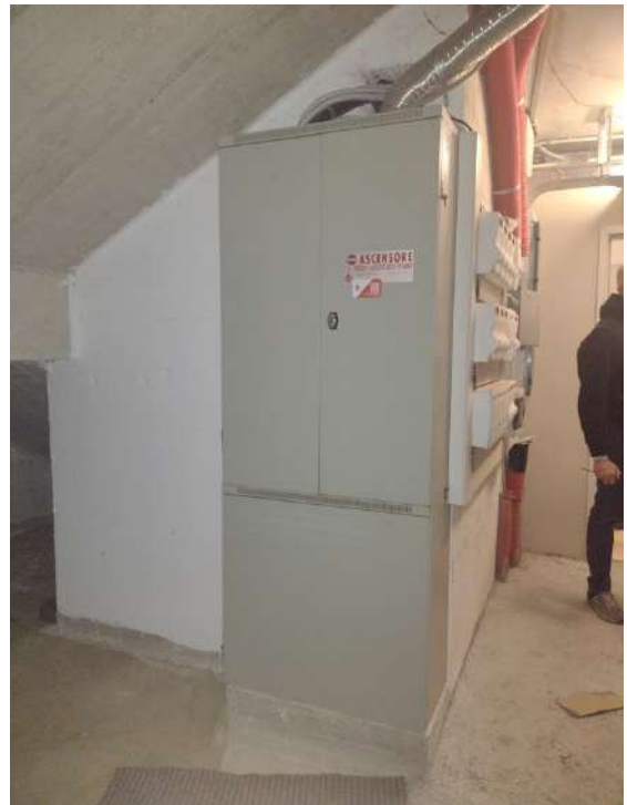
Loc tecnico p. s2
