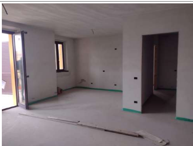
Interno tipo sub 31
