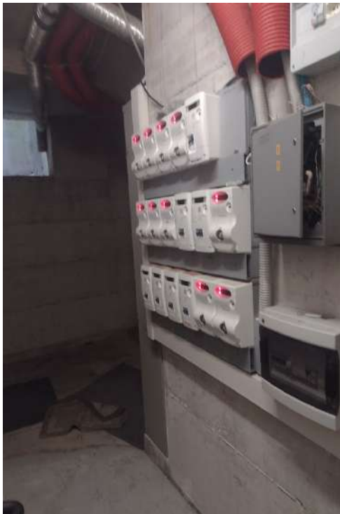
Loc tecnico p. s2
