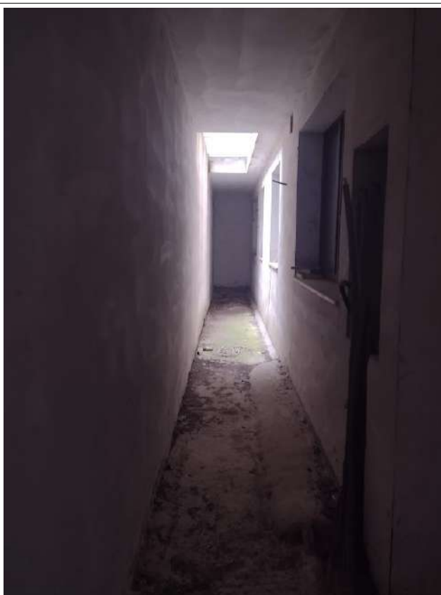
Vista cavedio sub 3
