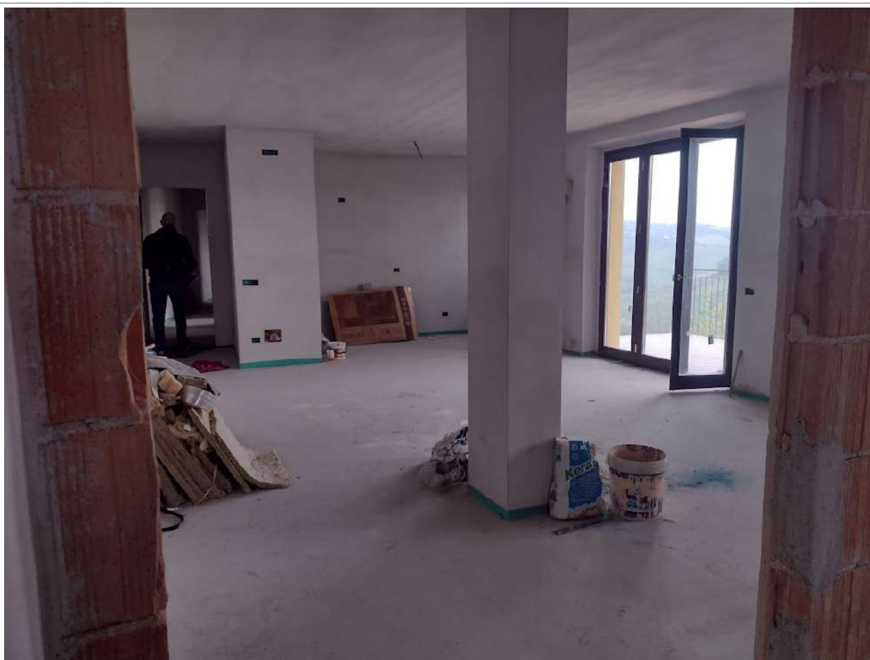
Interno tipo sub 37
