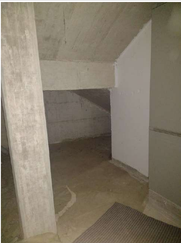
Loc tecnico p. s2
